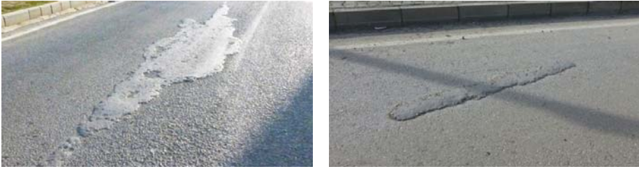
Şekil 5 Yol yüzeyine dökülen kalıntı örnekleri.
