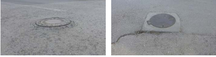
Şekil 4 Rögar kapaklarının yol kotuna göre yüksek kotta yapılan imalat örnekleri.
